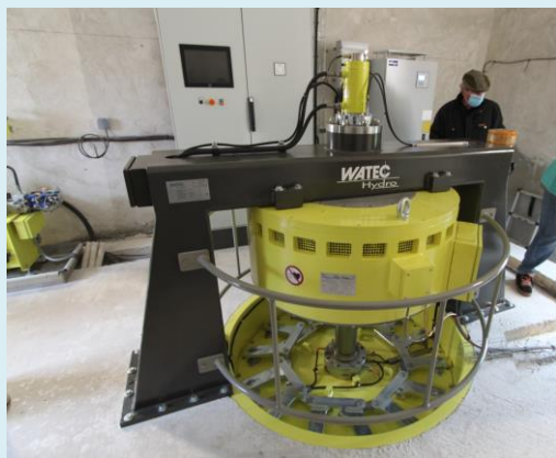
Turbine électrique du moulin de Chassy (Mhère)
